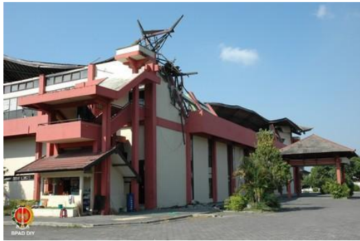
Gedung A Kerusakan Gedung Olah Raga Among Rogo di Jalan Kenari No. 1 Yogyakarta, akibat gempa bumi 2006
