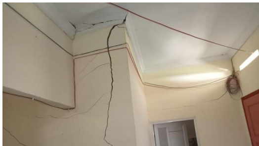
Gedung C Rumah warga rusak akibat gempa berkekuatan magnitudo 5,3 yang terjadi di Kabupaten Sigi, terjadi pada Minggu (6/8/2023) https://news.detik.com/berita/d-6861969/13-rumah-warga-rusak-akibat-gempa-susulan-di-sigi .
