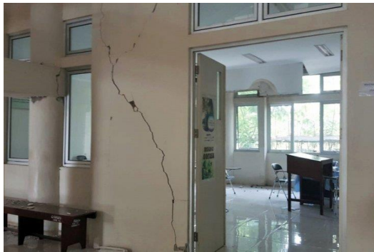
Gedung B Kondisi bangunan Fakultas Kehutanan Universitas Pattimura (Unpatti) Ambon, mengalami keretakan akibat gempa tektonik berkekuatan magnitudo 6,8 yang mengguncang Pulau Ambon dan sekitarnya, Kamis (26/9/2019) pagi sekitar pukul 08.46 WIT.
