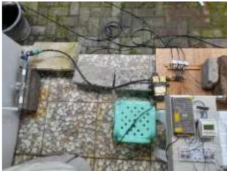
Gambar 4.11 Instalasi PLC dan Solenoid Valve
