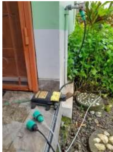
Gambar 3.8 Sumber Air, Pompa dan Jaringan Selang Penyiraman
